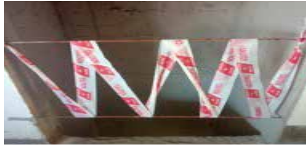
Shaft edge protection
